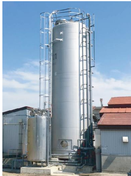
オゾン反応槽と生物処理槽
