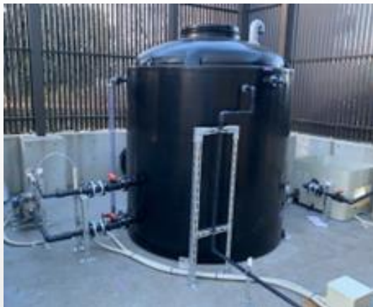
オゾン水貯蔵タンクとMNB装置
