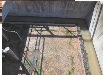
導入前の沈殿槽
