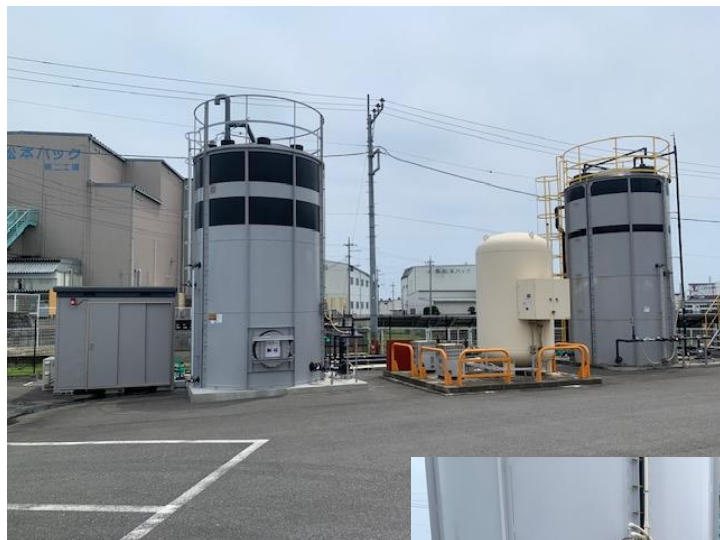
オゾン反応槽と生物処理槽
