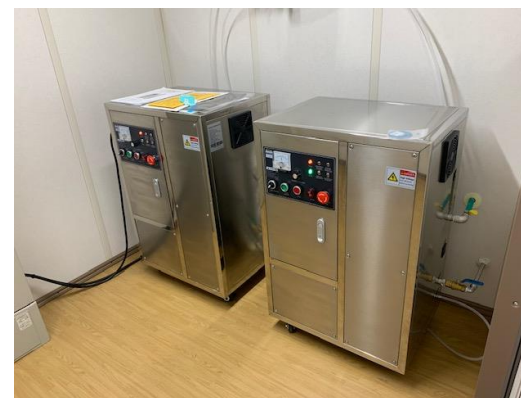
オゾン発生装置
