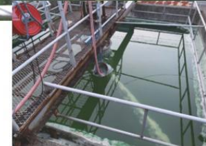
導入後の沈殿槽
