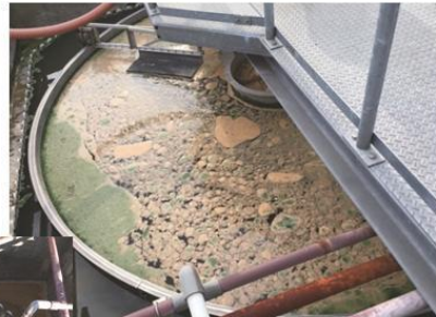
導入前の沈殿槽
