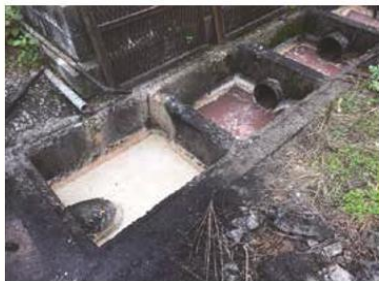
導入前の排水
