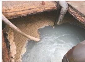
導入前の調整槽
