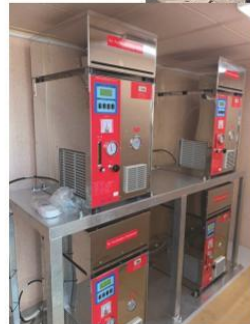
オゾン発生装置
