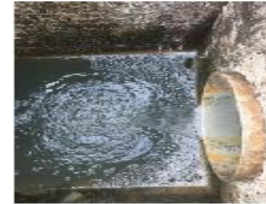
沈殿槽なしで放流
