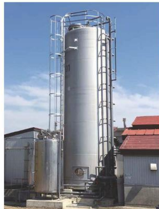
オゾン反応槽と生物処理槽
