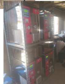
オゾン発生装置
