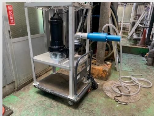
MNB発生装置(原水槽に設置)
