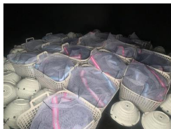
生物処理槽内部の担体
